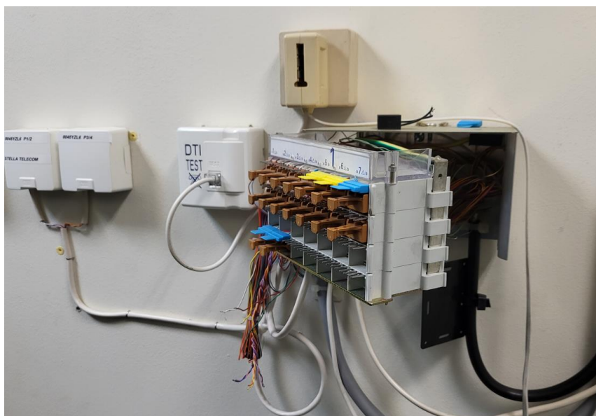
Photo 12 : Parafoudres sur la tête de câble télécom
