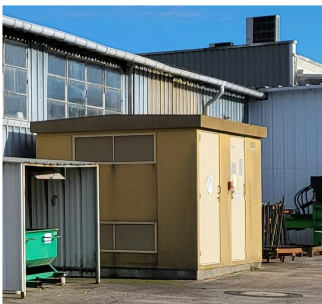
Photo 7 : Poste de livraison HT et TGBT.
